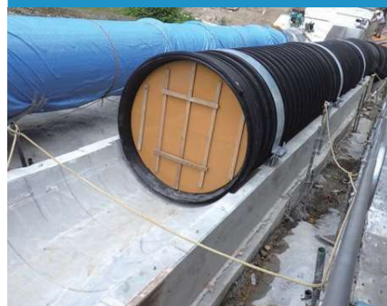
発電所 送水管受け台
